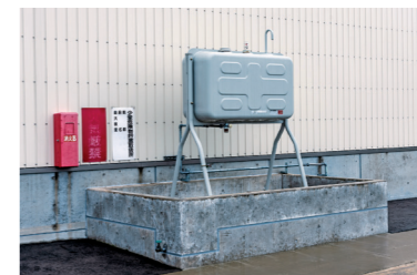
燃料タンク・防油堤
