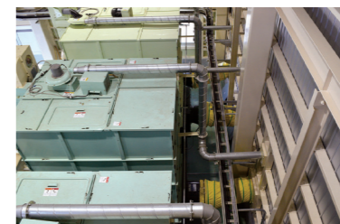
乾燥機排塵ダクト
