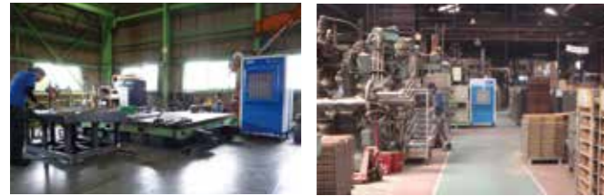
工場で使用 30mの強力涼風で作業環境を一新します。
